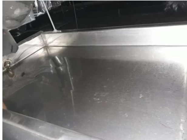
Figura 3 – Bandeja de Condensados
