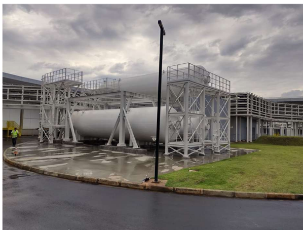
Foto vasos de pressão de hélio e local de instalação de cestas
