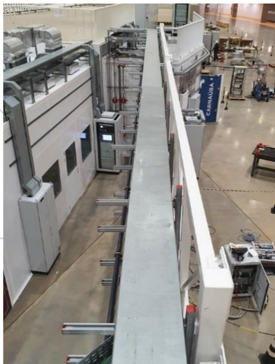
5 - Pipe Rack Eixo 35/36
