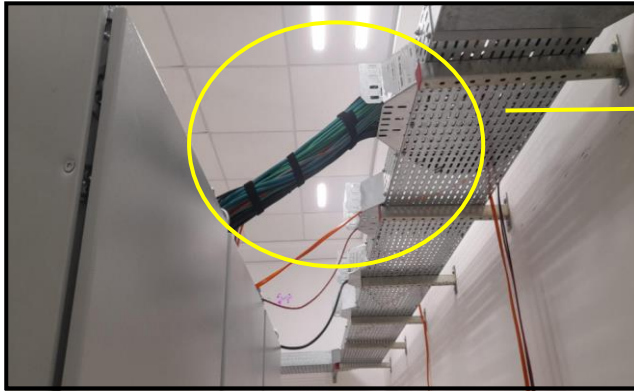
Figura 9: Cabo elétrico que alimenta os racks atualmente
