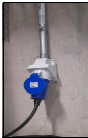
Figura 14: Tomada Steck das salas de rack
