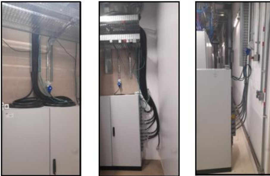
Figura 15:Infraestrutura existente nas salas de racks 1 a 20
