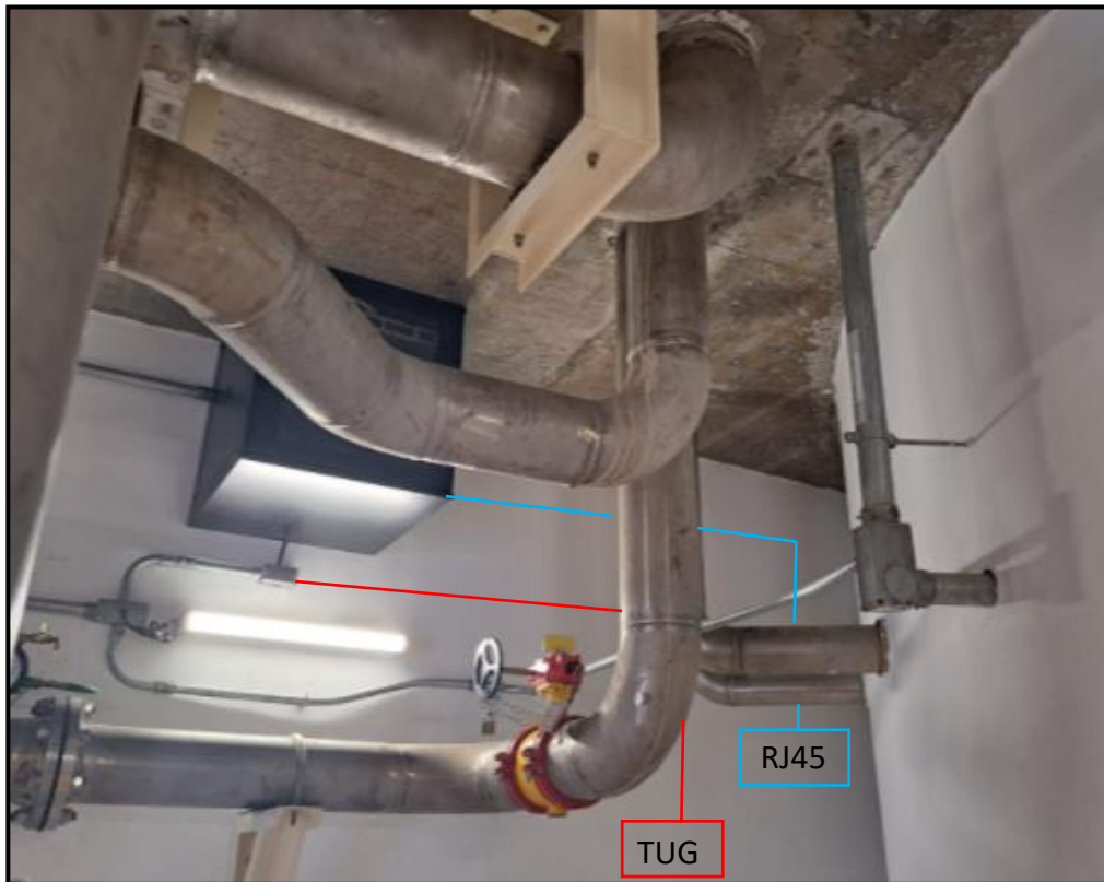
Figura 19: Demonstração de infraestrutura elétrica e de dados reservatório elevado
