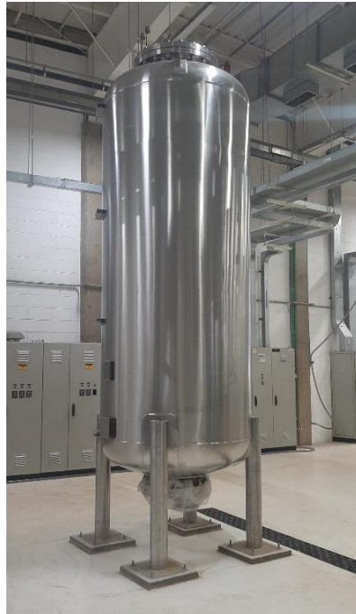
Figura 8 – Tanque Hidropneumático instalado (Diâmetro = 1,4 m e Altura = 4,6 m).
