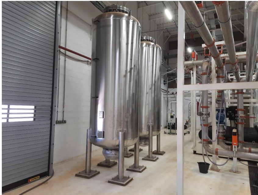
Figura 10 – Tanques Hidropneumáticos instalados para água desmineralizada.
