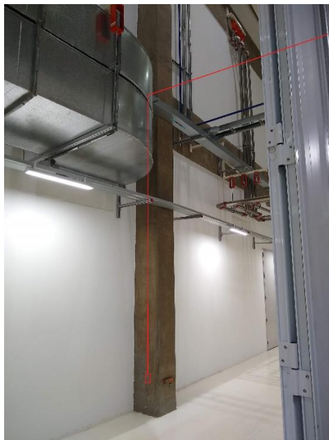
Figura 3 – Eletroduto para cabo de aterramento
