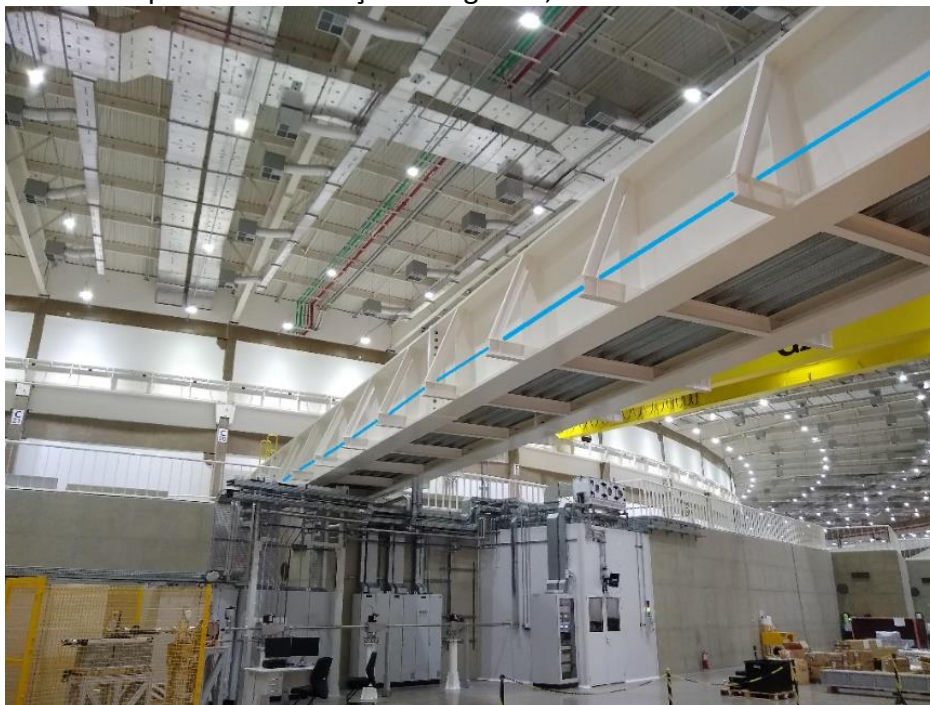
Figura 6 – Eletroduto de sinal tanque LNi
