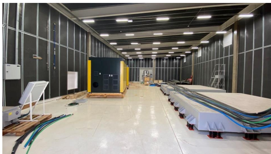
Figura 1: Sala de Compressores de Hélio
