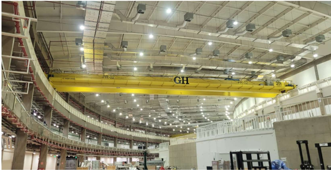
Figura 4 – Ponte rolante Sirius
