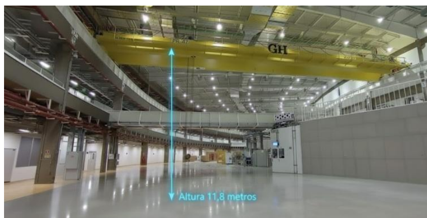
Figura 14: Ponte Rolante para transporte de materiais
