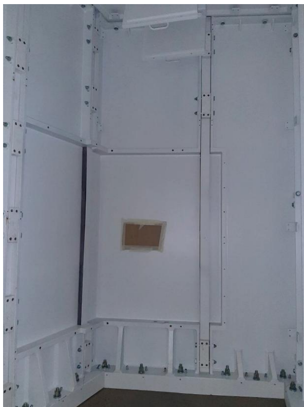
Figura 12 - Condição do local de instalação.
